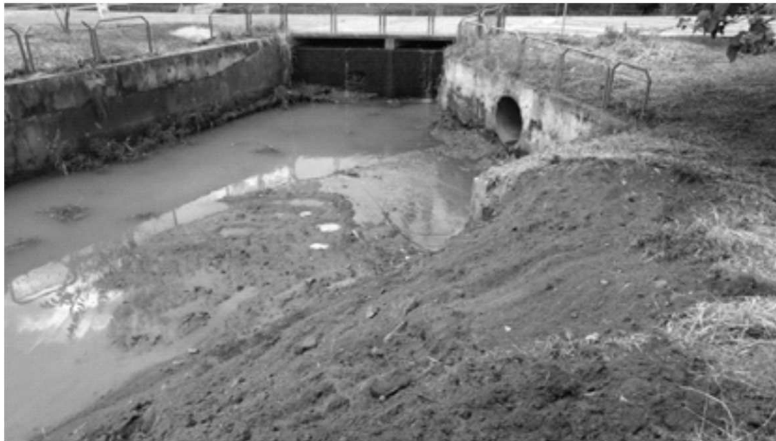
Degradação da área, presença de erosão e entrada clandestina de esgoto.
